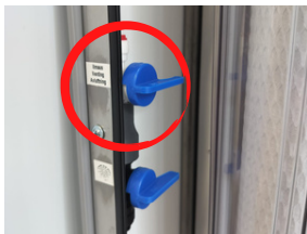
Luftningskran på enheten
