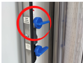
Luftningskran på enheten
